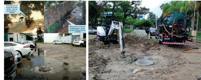
Figura 30 – Instalação de caixa de areia em rede de esgoto da concessionária para redução de extravasamentos de esgotos, em 26/11/2021.
